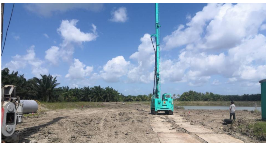
รูปที่ 15 การใช้แผ่นเหล็กรองรับฐานเครื่องจักร
