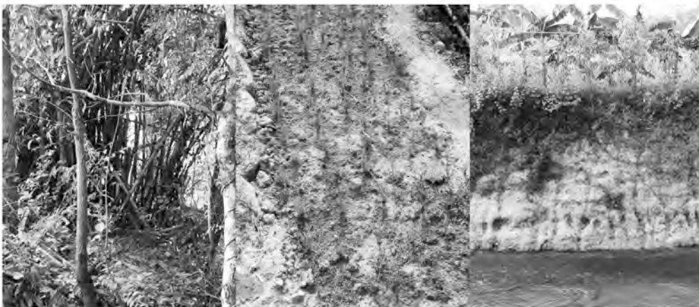
รูปที่ 4 การเปลี่ยนแปลงการใช้พื้นที่ริมตลิ่งจากกอไผ่ เป็นผักสวนครัวและไม้ใช้สอย ทำให้พื้นที่ริมตลิ่งถูกกัดเซาะ
